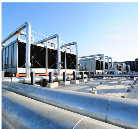
Større chiller-anlæg, som ofte bruges til komfortkøling eller datacentre. Datacentre er i en eksplosiv udvikling og bliver større og større hele tiden.
