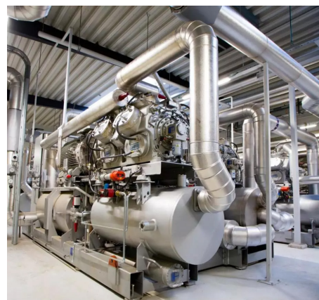
Industrikøling eller varmepumpeløsning på naturlige kølemidler.
